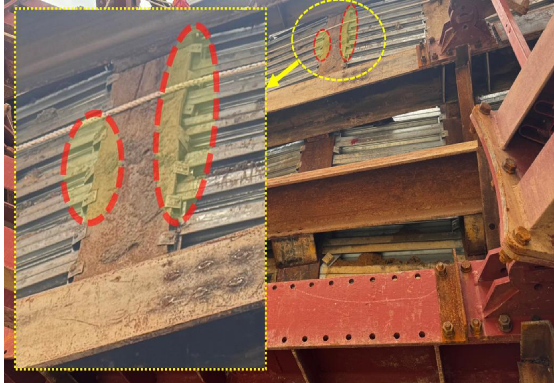
쌓기부 가설 구조물의 H형강과 철판 연결부 — 국부적 좌굴·이격 현상 관찰
